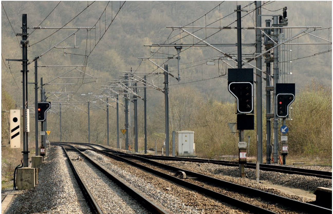
Gendron-Celles, sur l'Athus – Meuse électrifiée en 25 kV : on voit bien l'alternance de bras courts et longs. À un bras court sur la voie de gauche (vers Bertrix) correspond un long sur celle de droite (vers Dinant), ce qui fait que les zigzags des deux voies sont rigoureusement parallèles.
